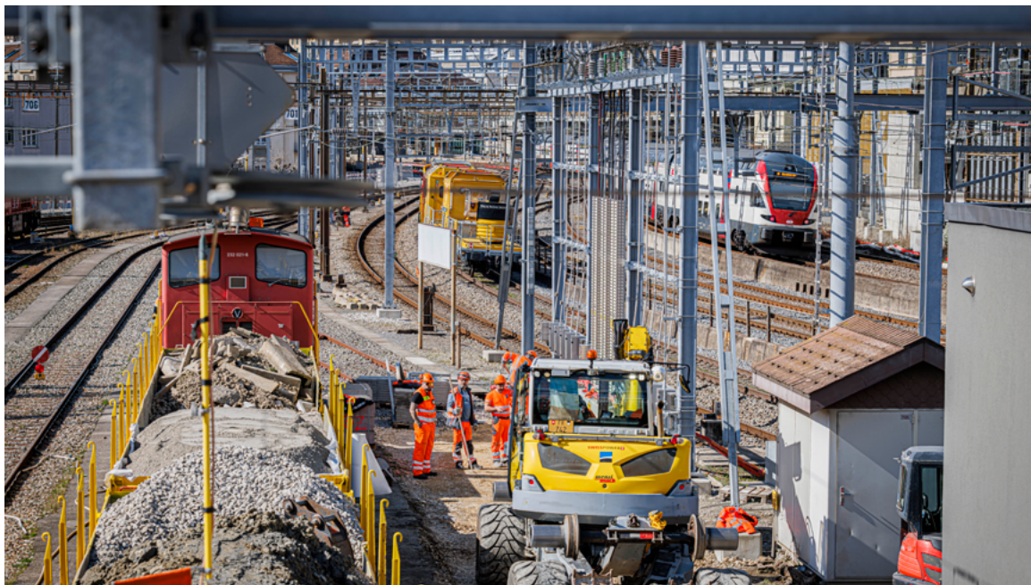
Les travaux de voies sur la tête Est de la Gare de Lausanne, pour préparer à la future géométrie de la gare.
