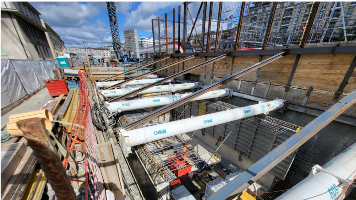
Vue des travaux du bassin de rétention des eaux dans le quartier de Jurigoz.
