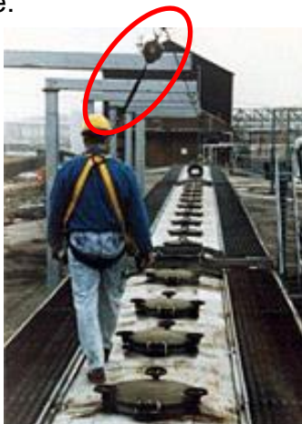
Fest installierte mitlaufende horizontale Absturzeinrichtung mit Höhensicherungsgerät
