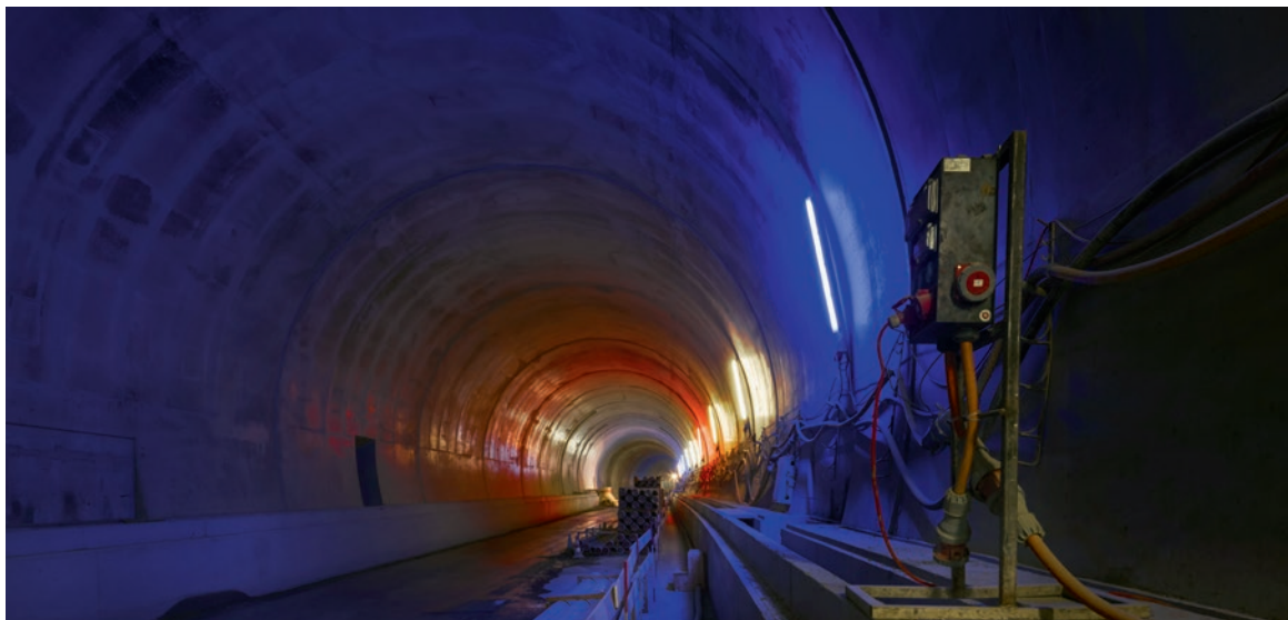
◀ Le tunnel de Champel avant la pose des équipements ferroviaires. © CEVA
