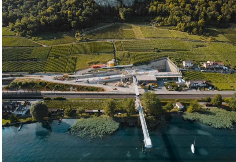
La zone de chantier au portail ouest du tunnel avant le début des travaux de creuse, une fois le convoyeur installé.
